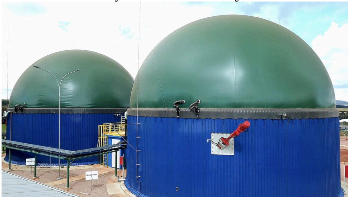
Figura 14. Estrutura da usina de biogás
