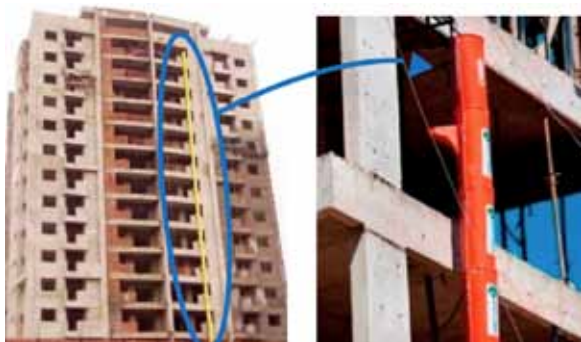
Figura 11 – Tubo condutor vertical de entulho.
